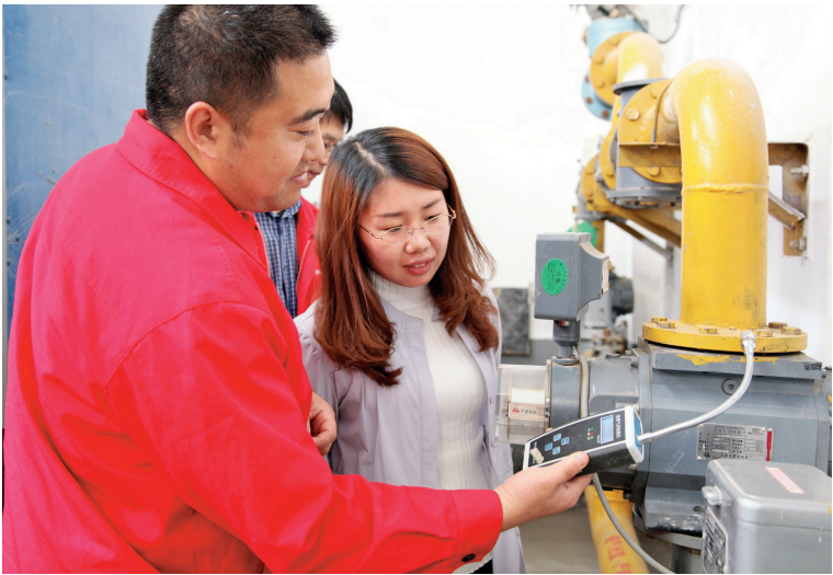
燃气锅炉安检
